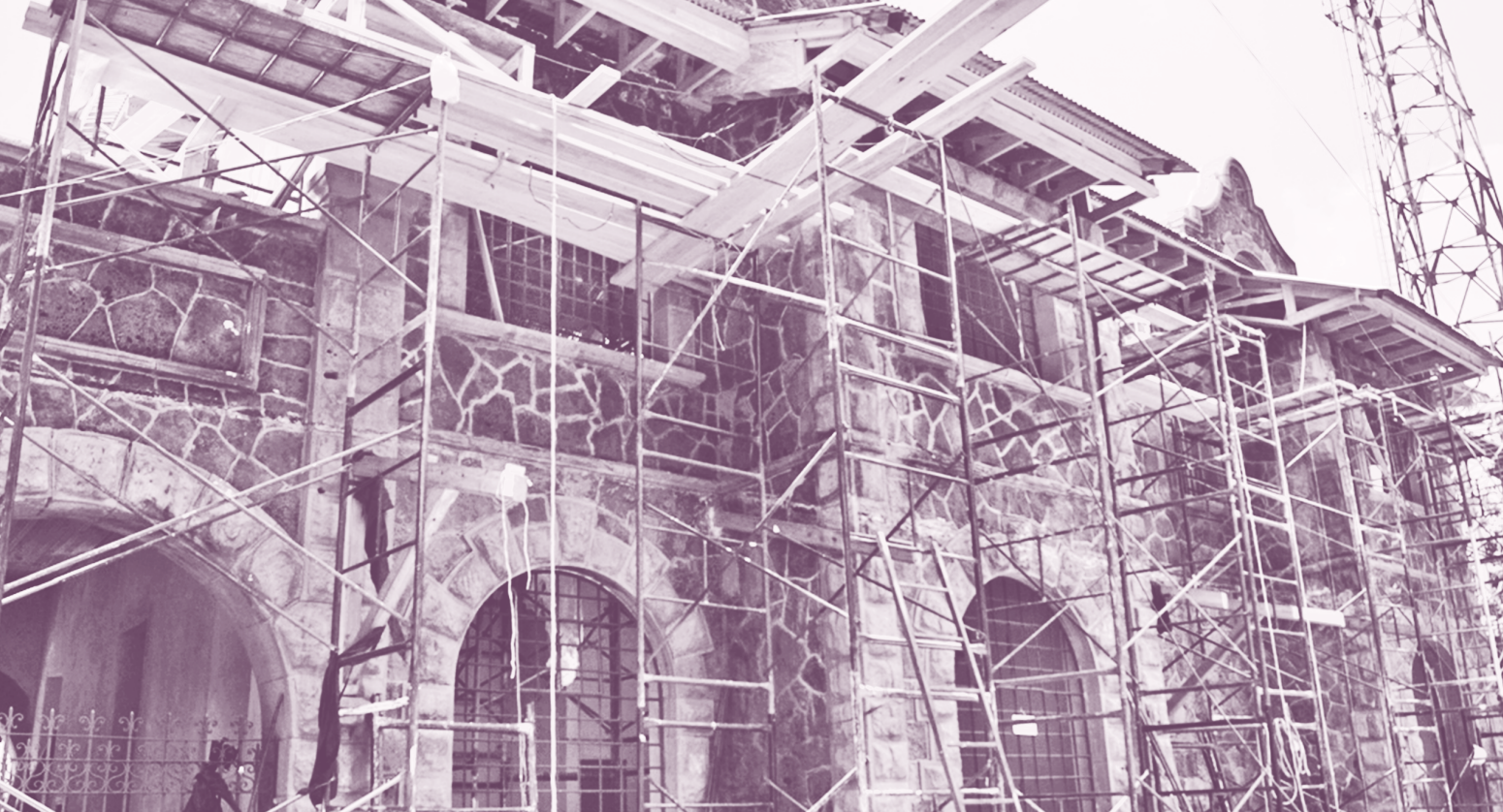
Figura 1. Reconstrucción de la antigua estación de ferrocarril, Cuernavaca, Morelos. Fotografía: Lucrecia Rubio
