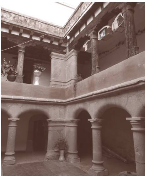
Figura 2: Vista de pie derecho de madera en el convento de San Luis Obispo Huexotla, Estado de México.
