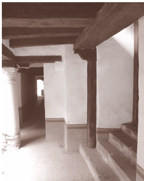
Figura 3: Detalle de can en la iglesia de San Nicolás Oxtotipac, Estado de México Fotografía: Rodrigo Floresvillar Ortiz
