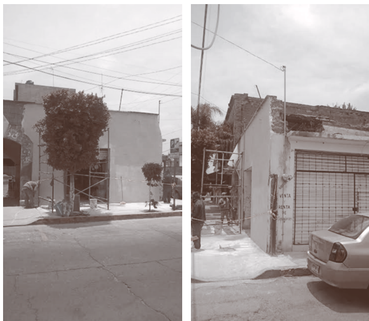
Figura 3. Aplicación de aplanados de cemento sobre un muro de adobe en el Centro Histórico de Texcoco de Mora, Estado de México. Fotografías: Ricardo Sánchez.
