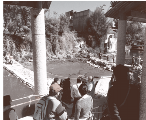
Figura 8. Xochimilco amenazado. Al fondo del paisaje, vivienda con materiales industrializados, y en la parte central, grieta en el canal, Xochimilco, Ciudad de México. Fotografía: Verónica Díaz, 2017.
